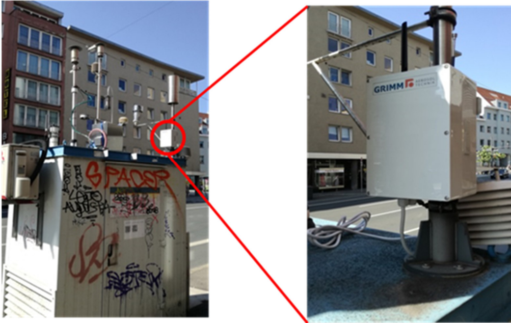
Abbildung 8: Das EDM80NEPH an der Messstelle Karlstraße
